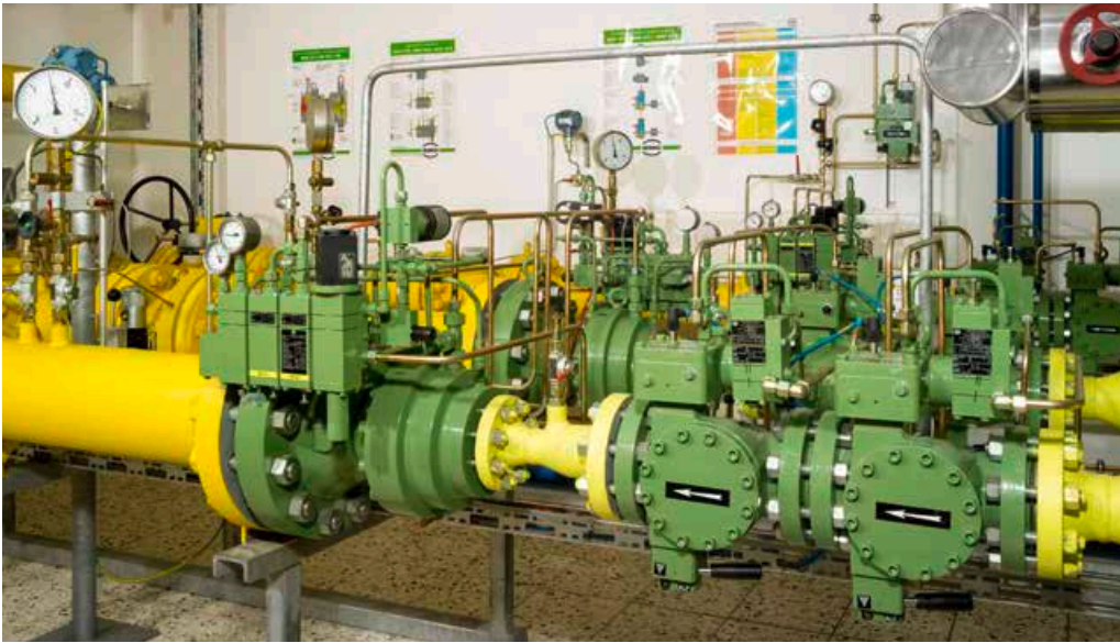
Gasdruckregelanlage in der Gasdruckregelstation Hängelbach
