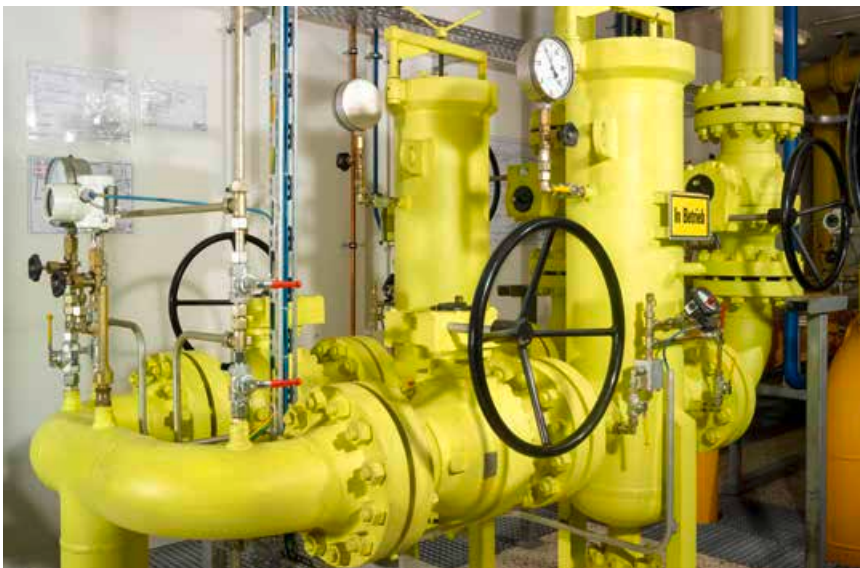
Gasfilter in der Gasdruckregelstation Hängelbach
